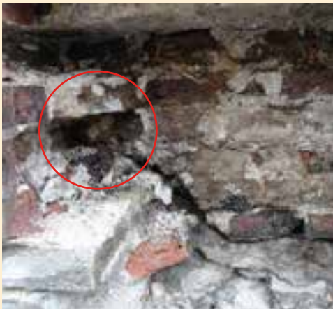
▲ Een vleermuis vindt onderdak in een gebarsten muur.
